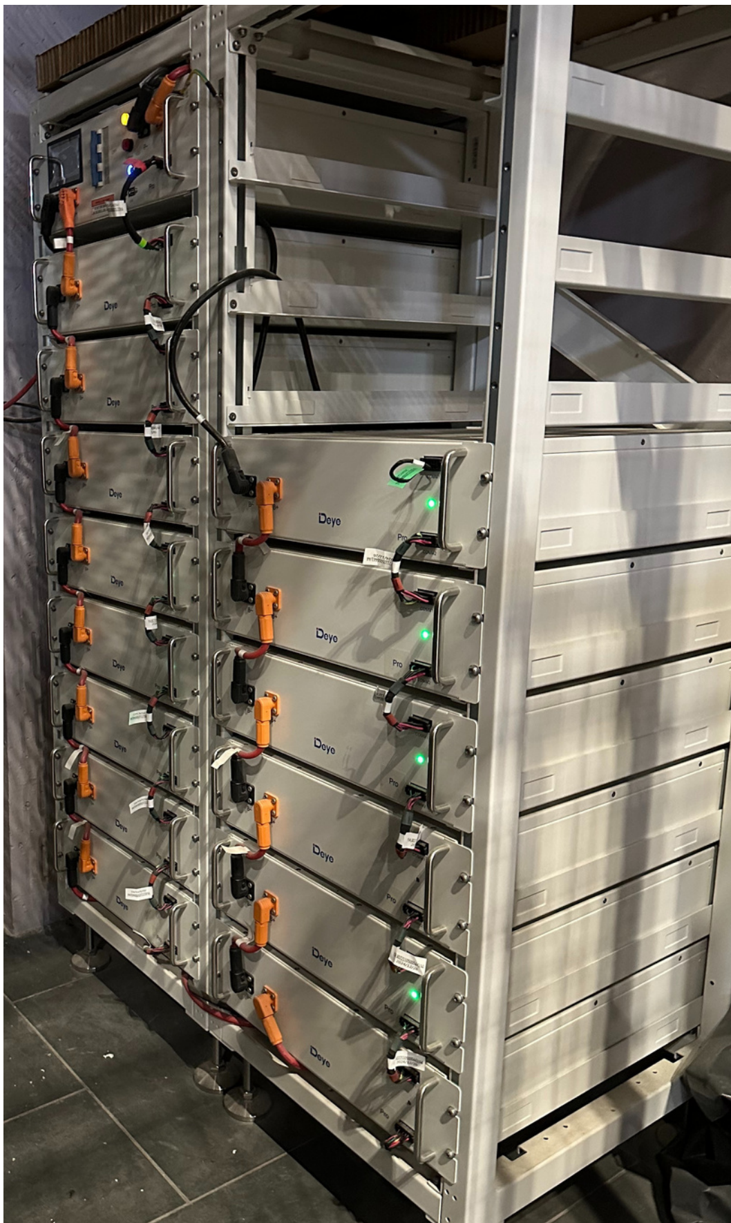
елементи безперебійного живлення на 50 кВт
